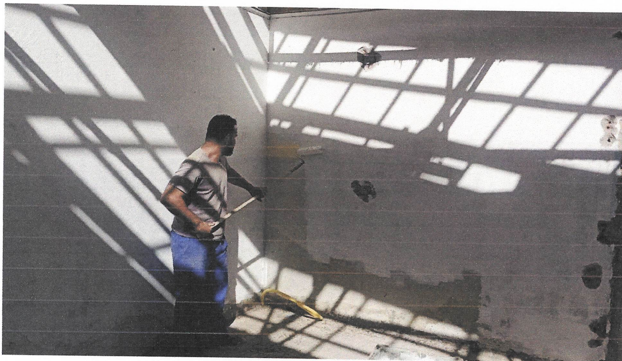
Foto 15 – APLICAÇÃO MANUAL DE FUNDO SELADOR ACRÍLICO EM PAREDES EXTERNAS DE CASAS. AF_06/20
