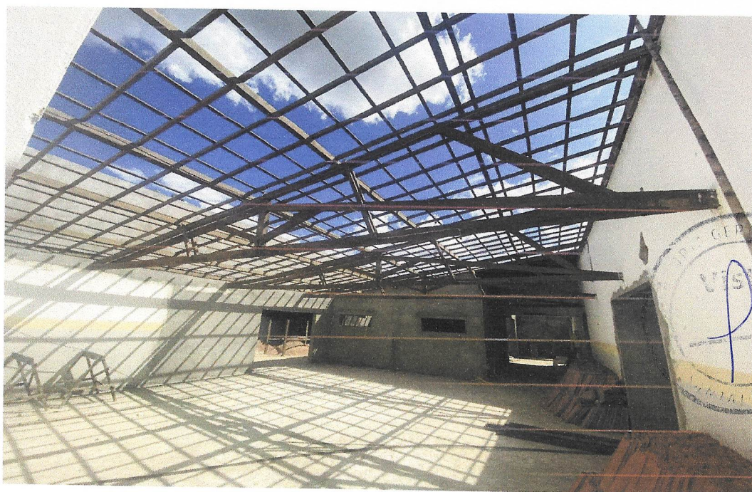
Foto 04- TRAMA DE MADEIRA COMPOSTA POR RIPAS, CAIBROS E TERÇAS PARA TELHADOS DE MAIS QUE 2 ÁGUAS PARA TELHA CERÂMICA CAPA-CANAL, INCLUSO TRANSPORTE VERTICAL. AF_07/2019
